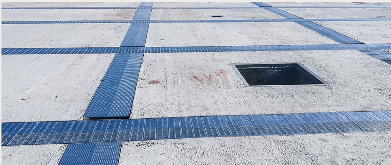
Canale și grile pentru aerare. Fotografie AGI.
